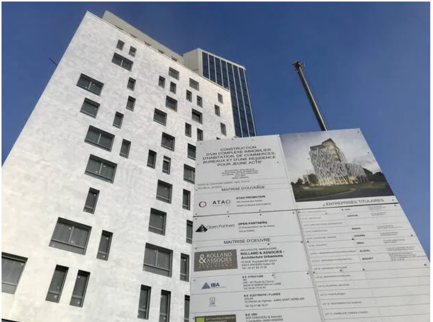
Plus de 70 ouvriers travaillent actuellement sur le chantier de la Tour TIP. Elle sera livrée en partie cet été. | CO – ANTHONY PASCO
